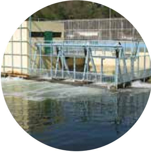
Ouvrage de régulation de Kervallon
